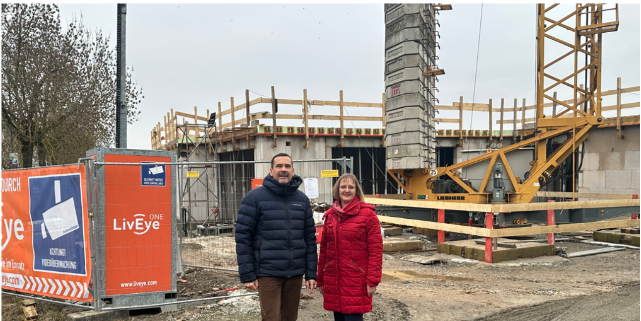
Lars Knobloch und Simone Horn vor dem Bau der neuen „Kita in der Eck“ im Süden Steinbachs
